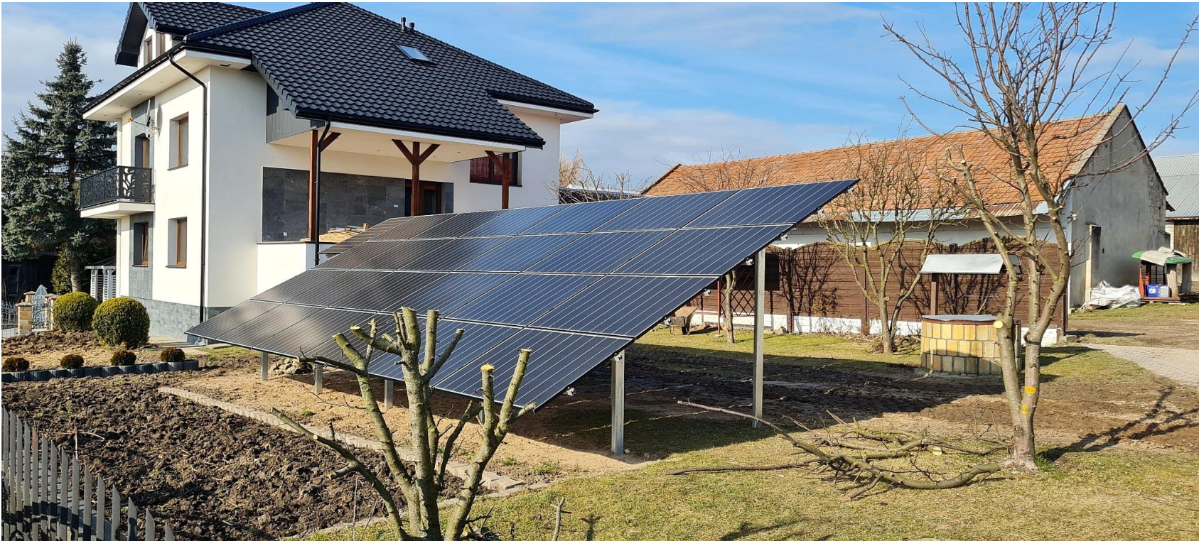
Instalacja fotowoltaiczna na gruncie
