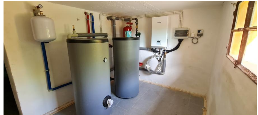
Jednostka wewnętrzna pompy ciepła wraz z zasobnikami centralnego ogrzewania i ciepłej wody użytkowej
