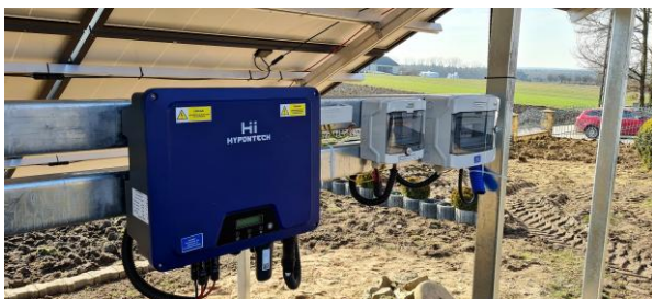
Falownik i aparatura instalacji fotowoltaicznej
