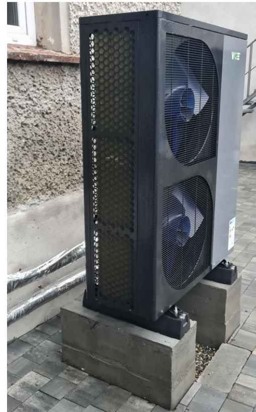
Zewnętrzna jednostka pompy ciepła typu powietrze-woda
