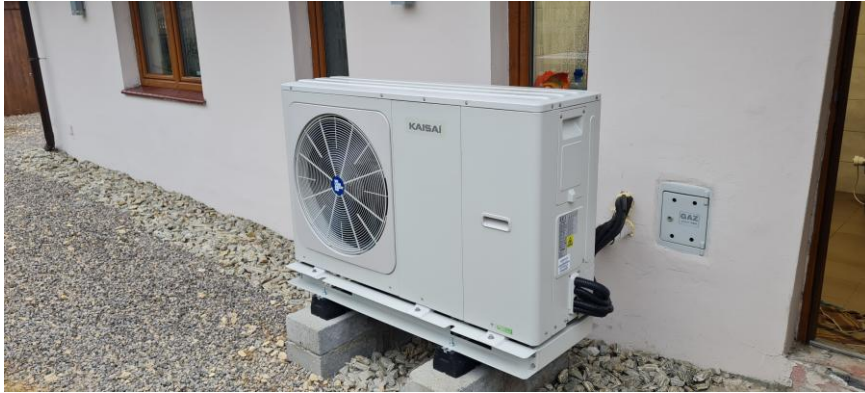
Zewnętrzna jednostka pompy ciepła typu powietrze-woda
